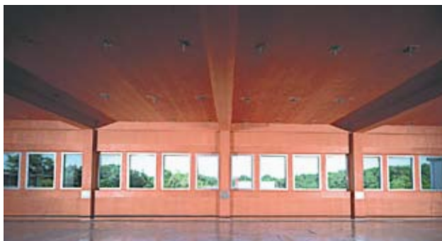
Ein emscreen -Raum mit geschirmten Fenstern vor dem Innenausbau
